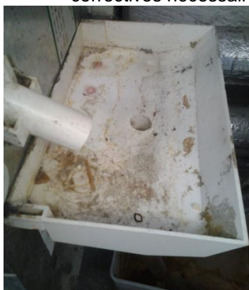
Figure 2.21 évacuation des condensats d'un ventilateur-convecteur avant nettoyage
