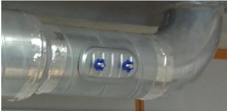
Figure 2.12 : conduit de ventilation muni d'un trapillon de visite
