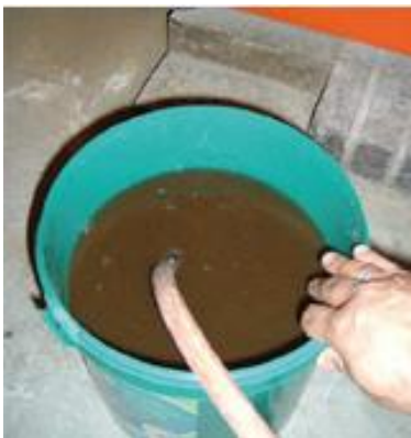
Figure 2.23 Exemple de dépôts recueillis en purgeant un séparateur de particules
