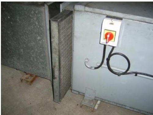
Figure 2.4 contrôle visuel d'un préfiltre
