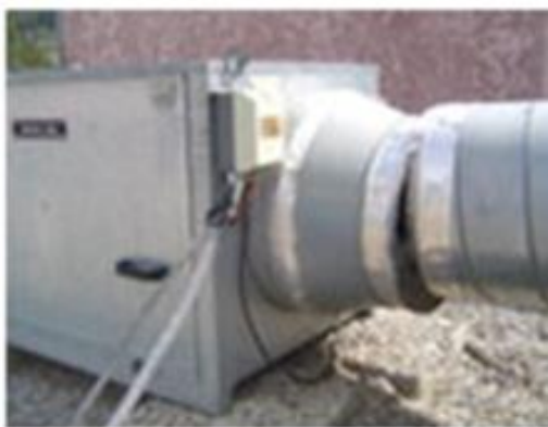
Figure 2.1 exemple de fuite à la sortie d'un groupe de ventilation
