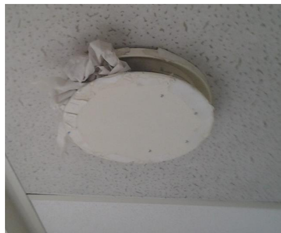
Figure 2.15 : problème de répartition du débit d'air
