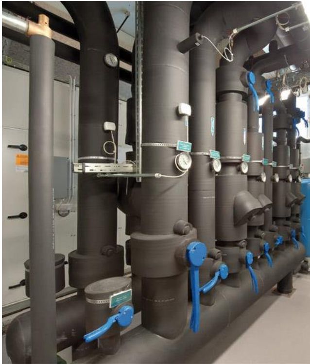
Figure 2.8 collecteur d'eau glacée – départs et retours des circuits munis de doigts de gant et de sondes de température
