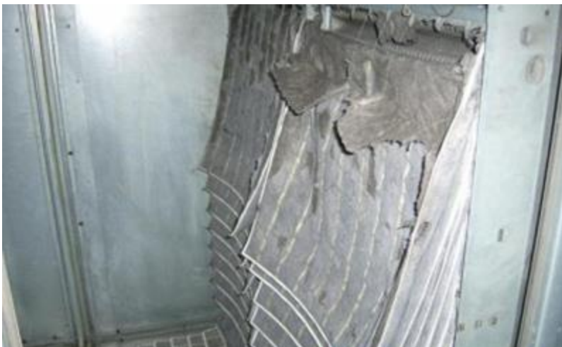
Figure 2.5 filtre à poches déchiré
