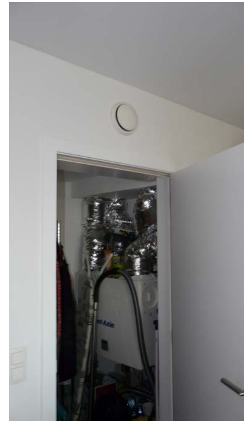
Une VMC située directement dans le logement, Zenobe Gramme
