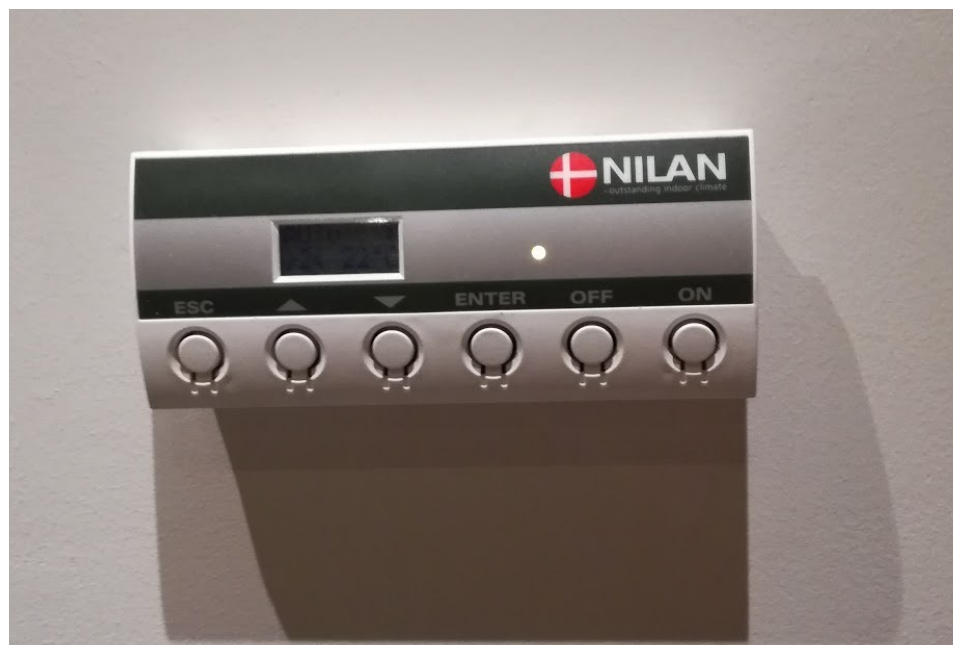
Borne de contrôle du "Nilan", VMC dans les Hauts de Bellevue, premier support aux différents différents réglages et mesures par les explorateurs
