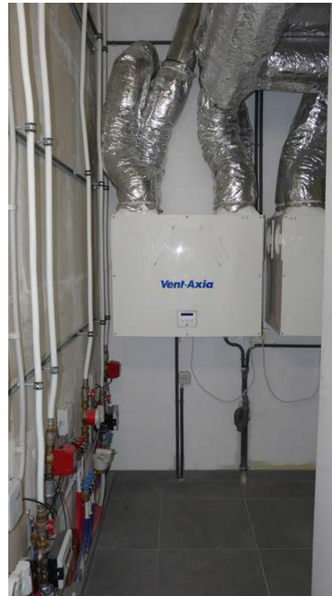
Un sas comprenant des VMC individuelles situé dans un couloir collectif.
