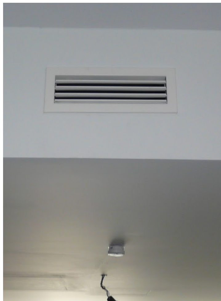
Bouche d'aération du système Nylan (Hauts de Bellevue). Par intuition, nombre d'habitants augmentent le flux de ventilation lorsqu'ils cherchent à rafraîchir leur intérieur.
