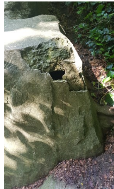
Figure 24: Rocaille endommagée laissant apparaître la structure creuse Photographie Noémie Pons-Rotbardt, juil 2021
