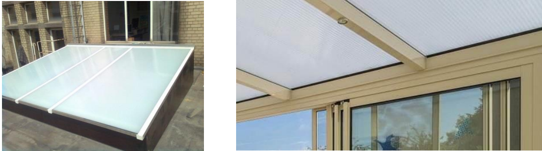
Figure 26 – Lanterneau en polycarbonate
