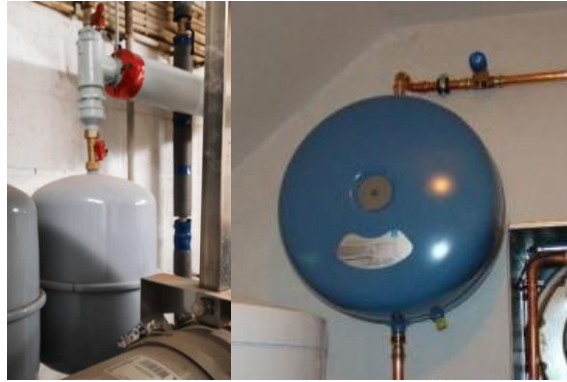
Afbeelding 63 – Expansievaten aangesloten op het SWW-circuit op één punt (links) en in lijn (rechts)
