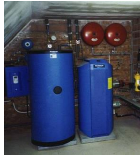
Afbeelding 61 – Collectieve installatie met voorraadvaten
