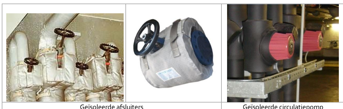
Afbeelding 43 – Volledige isolatie van afsluiters en pompen
