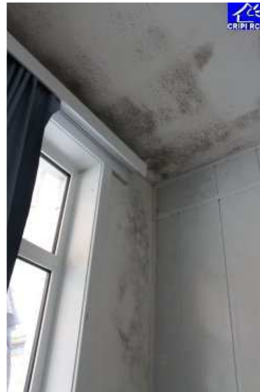
Photo 5 : Moisissures visibles (Source : CRIPI)
