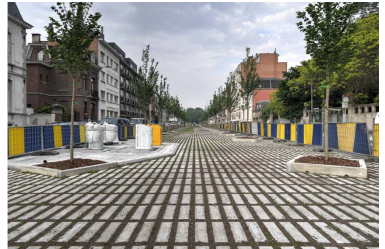
Voorbeeld van de aanleg van een drainerende verharding in betonklinkers met verbrede voegen (Vrijheidslaan) © Brussel Mobiliteit.
