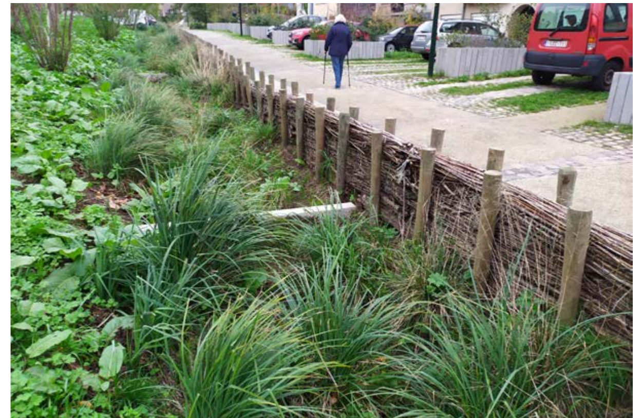
Figuur 1. Takkenbundel die de ruimte tussen de weg en de voorziening voor regenwaterbeheer afbakt om deze laatste te beschermen tegen de manoeuvres van de voertuigen (Bron: Leefmilieu Brussel).
