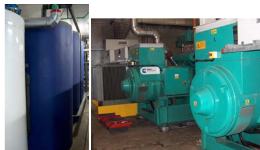
Réservoir de stockage solaire (photo de gauche) Les 2 cogénérateurs au gaz (photo de droite)
