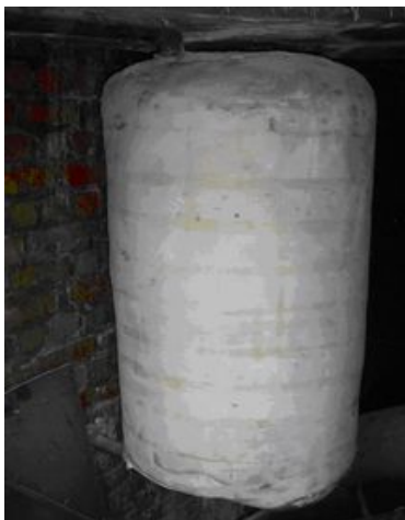
Met asbesthoudende pleister geïsoleerd expansievat
