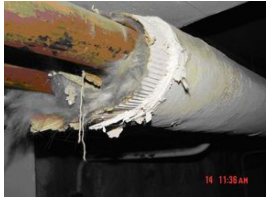
Warmte-isolatie: de asbestvezels bevinden zich in de buitenste pleisterlaag
