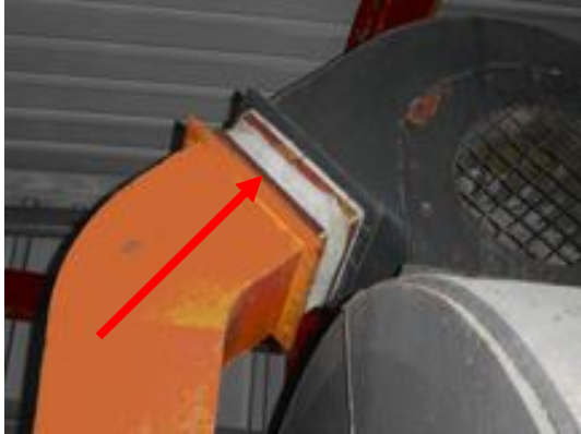
Trillingdempende balg ter hoogte van de verbinding tussen ventilatiekoker en motor
