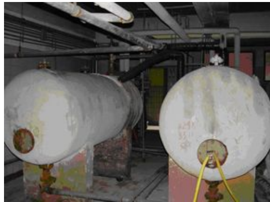
Warmwaterreservoirs bekleed met asbesthoudende pleister
