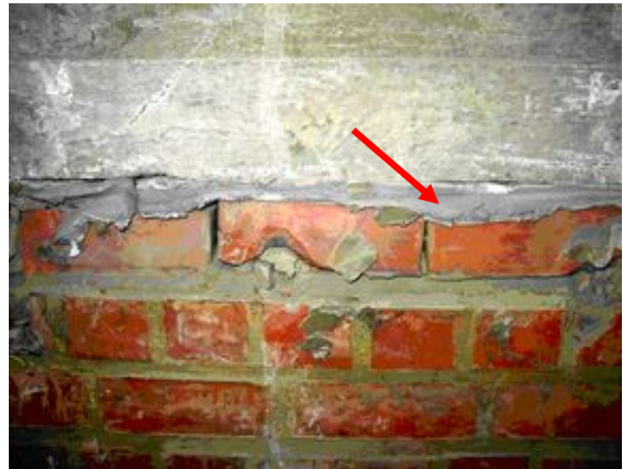
Uitzetvoeg in schuim met blauwe asbestvezels (ter hoogte van de overgang van de bovenkant van een muur en het betonnen plafond)
