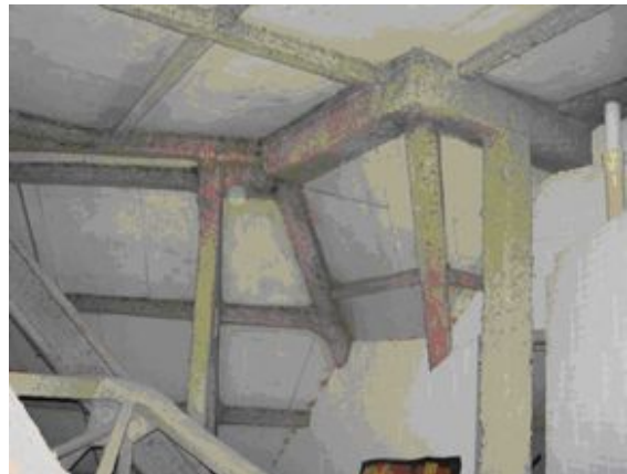
Sputasbest met amosiet (niet ingekapseld) op metalen steunbalken en isolerende platen van het type « Pical ».
