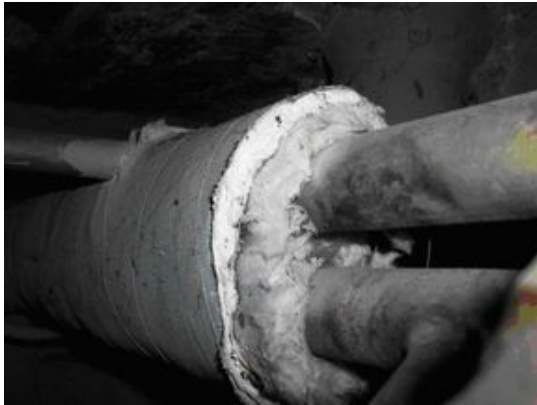
Warmte-isolatie: de asbestvezels bevinden zich vaak in de dunne buitenste pleisterlaag
