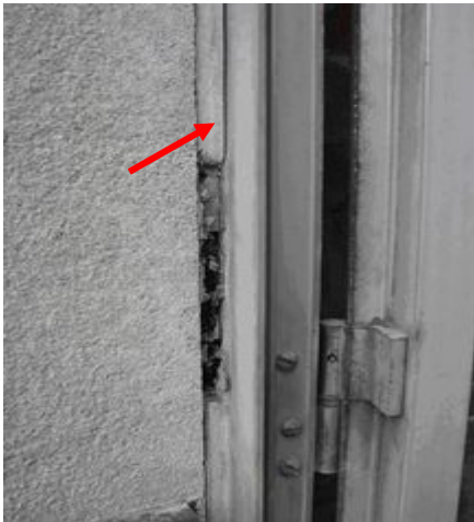
Asbesthoudende mastiek aan een vensterlijst
