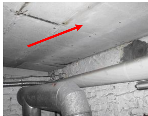
Rf valse plafondplaten van het type 'Pical' in een stookruimte (kenmerkende wafelstructuur)
