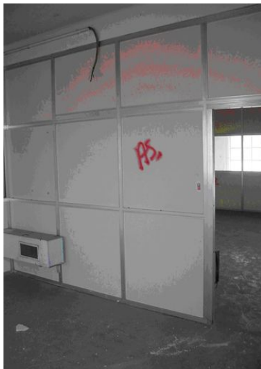
'Glasal' of 'Cloisal'-platen: binnenwanden van een kantoor
