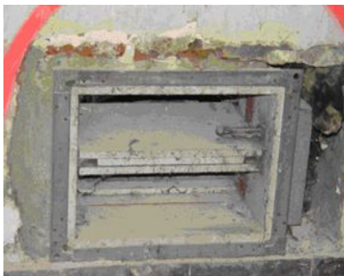
Brandwerende klep, aan de binnenkant met plaatmateriaal van het type 'Pical' bekleed. Het afsluitplaatje bestaat zelf ook uit dit plaatmateriaal.
