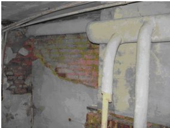
Oude éénlagige warmte-isolatie van asbestvezels bevattende diatomeeënaarde
