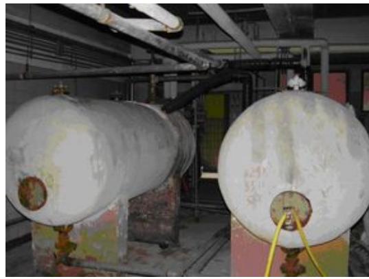
Réserves d'eau chaude enrobées de plâtre amianté
