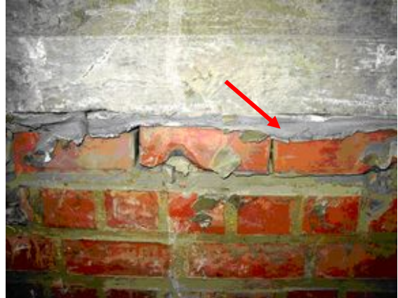
Joint de dilatation en mousse contenant des fibres d'amiante bleu (à la rencontre entre le haut d'un mur et le plafond en béton)
