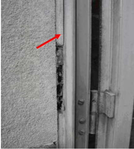
Mastic vitrier amianté pour l'étanchéité autour d'un châssis de fenêtre
