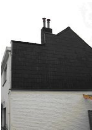
Ardoises noires en amiante-ciment sur le pignon d'une habitation et cheminées en amiante-ciment
