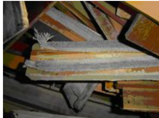
Rubans à l'arrière de chambranles de porte
