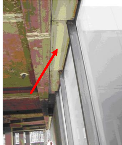
Plaques de type « Pical » pare-flammes fermant l'espace entre la dalle en béton et la façade (photo dans un immeuble de bureaux)
