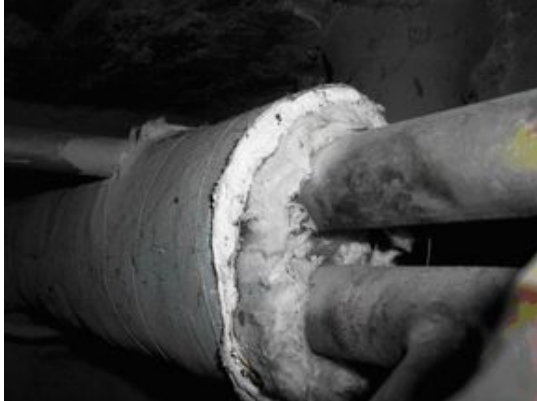
Calorifuge : les fibres d'amiante se trouvent dans la fine couche de plâtre périphérique
