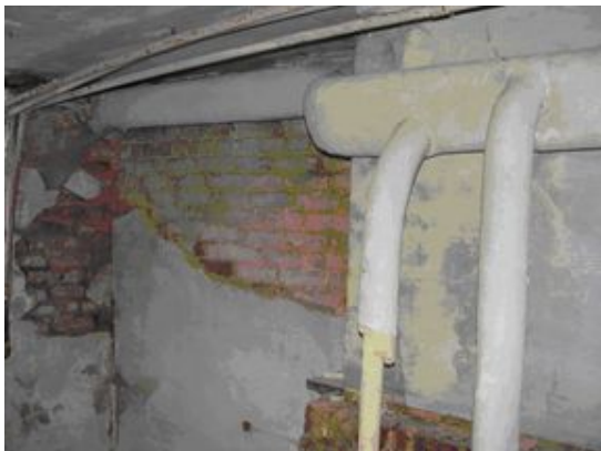
Vieux calorifuge monocouche en terre à diatomées chargée en fibres d'amiante
