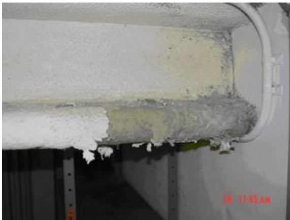
Flocage d'amosite (gris) avec sa couche extérieure d'encapsulation (peinture épaisse) sur une poutre métallique en forme de « I ». On remarquera la surface extérieure plissée.
