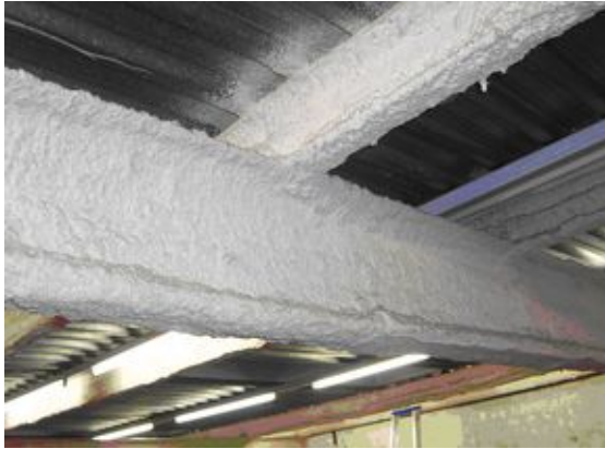
Plâtre dur amianté projeté sur des poutres métalliques de structure.
