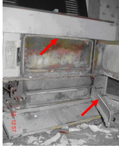
Cordes sur le cadre de la porte d'un poêle et sur la porte du tiroir à suie
