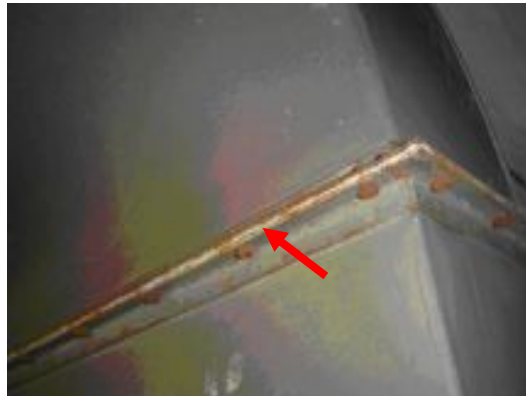
Cordelette au niveau de la bride entre deux éléments de gaine de ventilation
