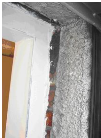
Crépi mural extérieur amianté
