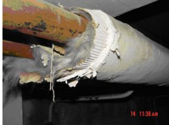
Calorifuge : les fibres d'amiante sont localisées dans la couche de plâtre extérieure
