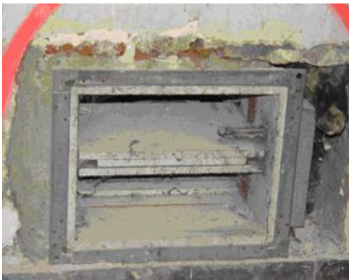
Clapet coupe-feu bardé intérieurement de plaques de type « Pical ». La lame de fermeture est elle-même constituée de plaques de type « Pical »
