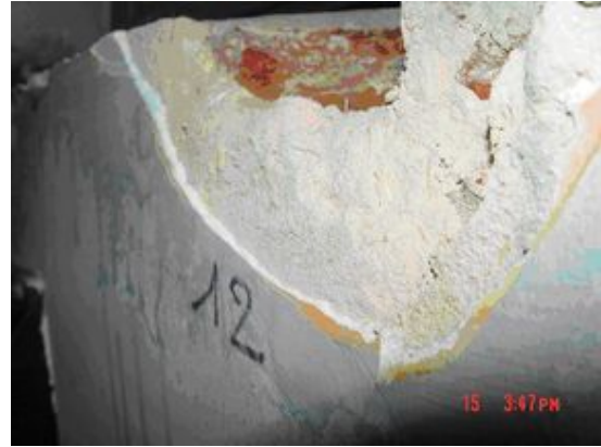
Fine couche de finition murale en plâtre contenant des fibres d'amiante
