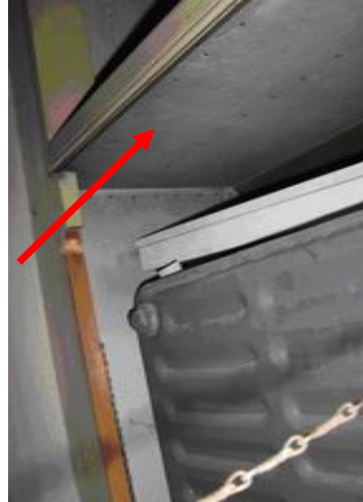
Carton d'amiante (surface légèrement plissée) dans un habillage autour d'un radiateur
