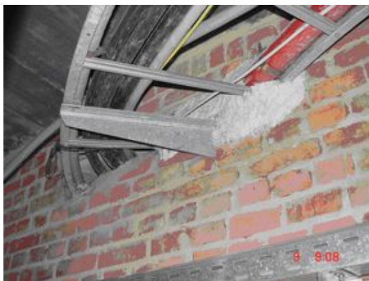
Bourre d'amiante là où des câbles électriques traversent un mur.
