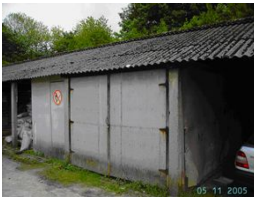
Double porte et parois en amiante-ciment d'un local de stockage. La toiture est constituée de plaques ondulées en amiante-ciment
