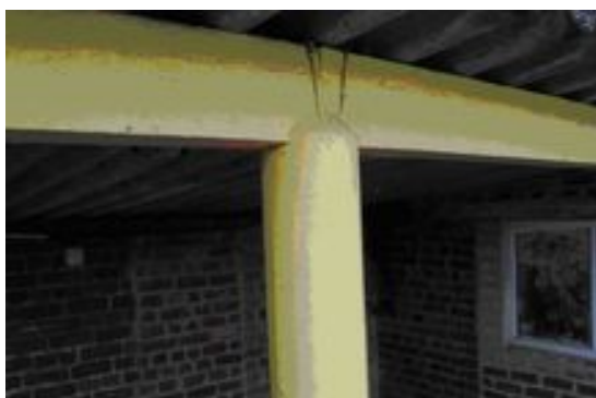
Tuyau en amiante-ciment utilisé comme coffrage perdu pour constituer le pilier de soutien d'un préau. Le gaufrage extérieur est caractéristique.
