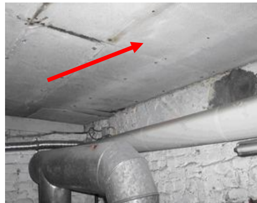
Plaques de faux-plafond Rf de type « Pical » dans une chaufferie (gaufrage caractéristique)
