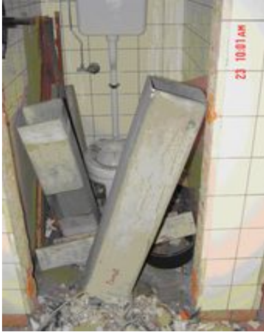
Gaines d'aération en amiante-ciment (dans des sanitaires)
