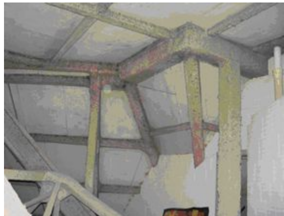
Flocage d'amosite (non encapsulé) sur des poutres métalliques et plaques d'isolation intérieure de type « Pical ».
