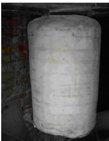
Vase d'exposition calorifugé avec du plâtre amianté
