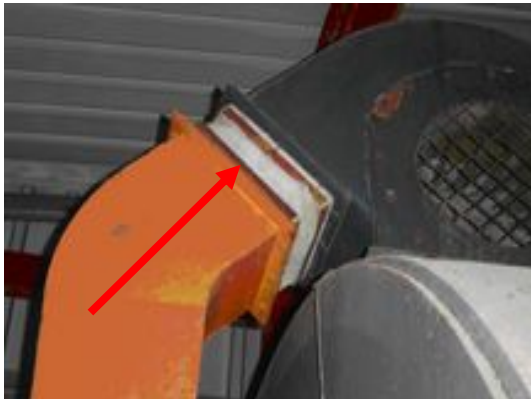
Soufflet anti-vibratoire à la jonction entre gaine de ventilation et moteur
