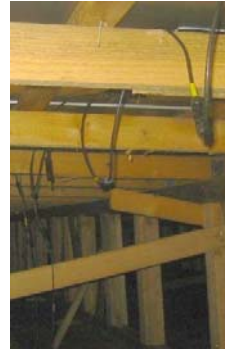
Câble non fixé sur une structure inflammable
