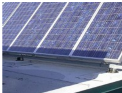
Figure 8 : exemple d'ombre causant la perte de la quasi totalité de la production
