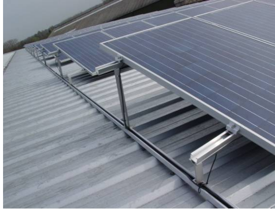
Figure 3 : Captageurs solaires PV dont la structure portante en métal est fixée à la structure du bâtiment. (Projet Limburgse Tuinbouwveiling, Herk-de-Stad).
