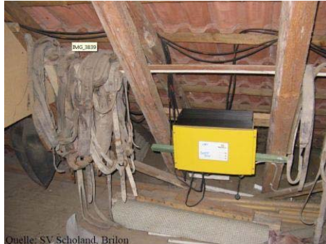
Onduleur dans un endroit inflammable
