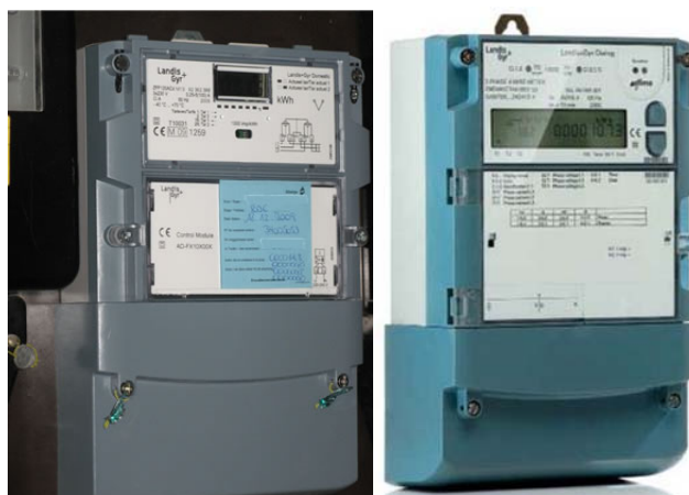
Figuur 1: Elektriciteitsmeters van Sibelga
