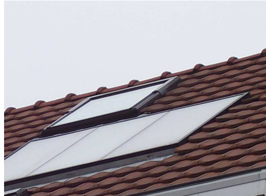
Figure 2. capteurs intégrés à la toiture
