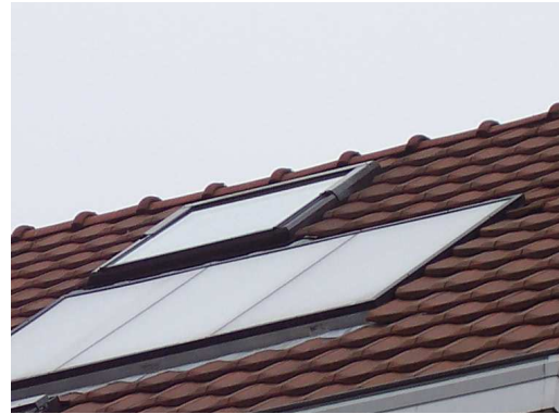
Figuur 2. dak met geïntegreerde collectoren
