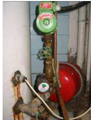
Figuur 5. corrosie van het vat
