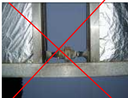
Figuur 3. geen isolatie van verbindingen tussen collectoren
