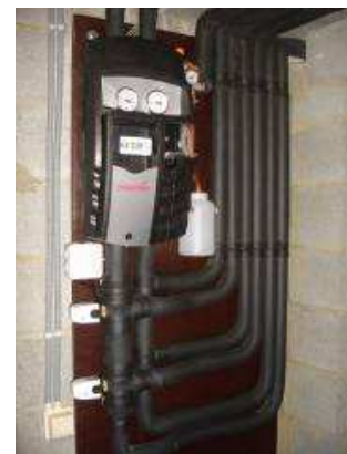
Figuur 4. perfect doorlopende isolatie volgens de huidige normen ; de leidingen zijn onzichtbaar
