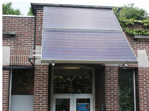
Les capteurs solaires thermiques en pare-soleil
