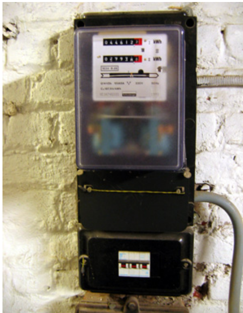
Elektriciteit : tweevoudig uurtarief
