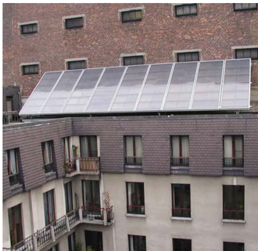
Champ de capteurs de 74 m 2 orientés sud-est
