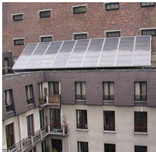
74 m 2 zonnecollectoren zuidoost georiënteerd
