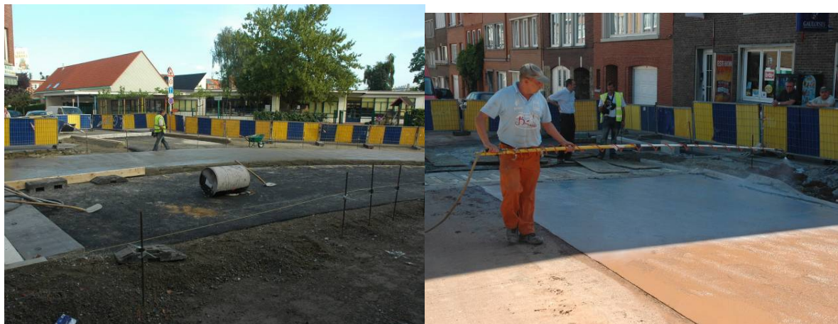
Ganshoren : base en asphalte + couche de béton gris inférieure Ganshoren : application du retardateur de surface
