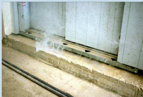
Test d'infiltrométrie avec fumigène au pied de la cage d'ascenseur (Source : Matriciel).
