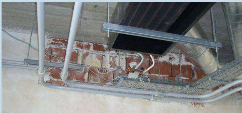
Exemple de mauvaise coordination entre corps de métiers (Source : Bruxelles Environnement - IBGE)
