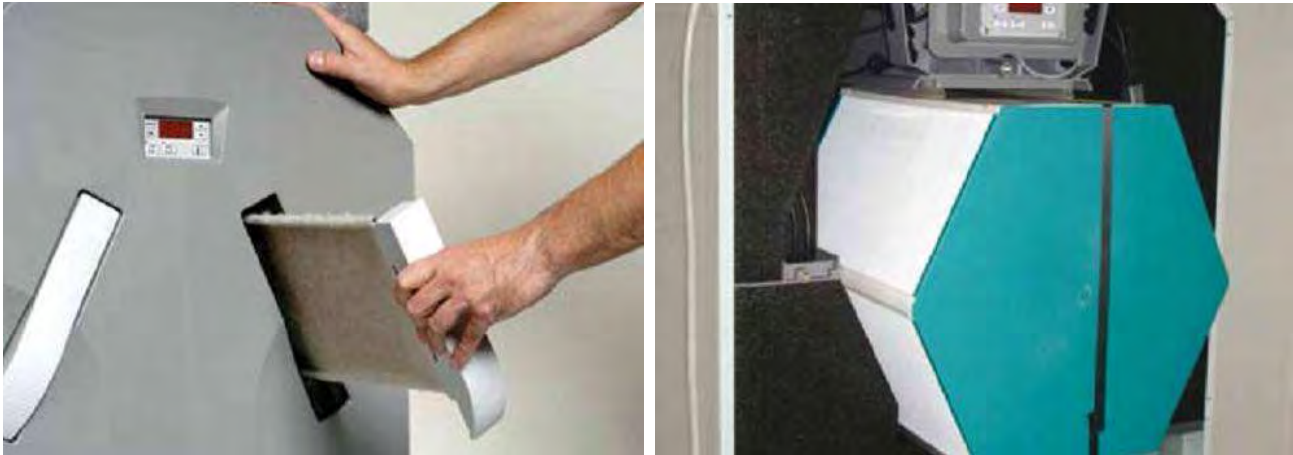
Reiniging van de filter en de warmtewisselaar (Bron: Stork air. Ter illustratie)
