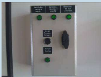
Témoins lumineux signalant le mode de ventilation actif dans les bureaux (Source : Caméléon)
