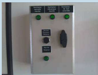
Controlelampjes die de actieve ventilatiemodus in de kantoren signaleren (Bron: Cameleon)
