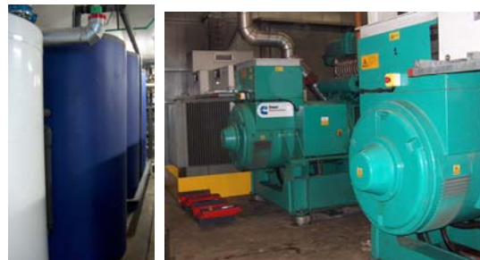
opslagvaten zonnestelsysteem (foto boven links) en 2 WKK-gasmotoren (foto boven rechts)
