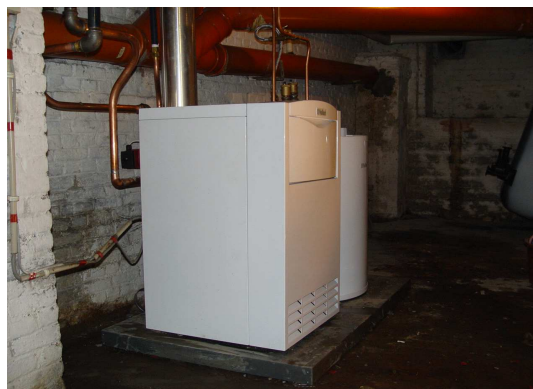
Figuur 1.3: voorbeeld van een nieuwe installatie
