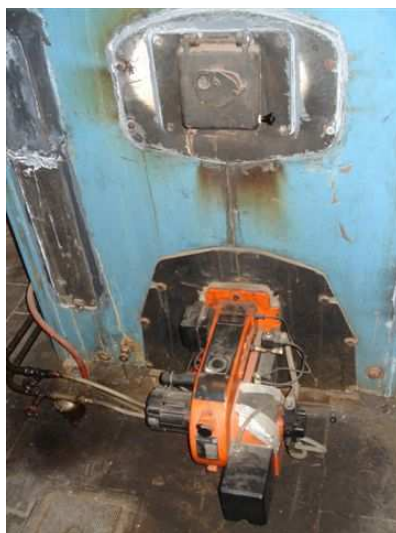
Figure 1.1: exemple de vieille chaudière à mazout
