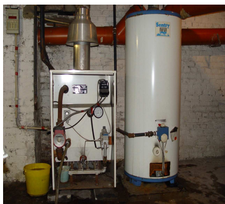
Figure 1.2: exemple de vieille installation
