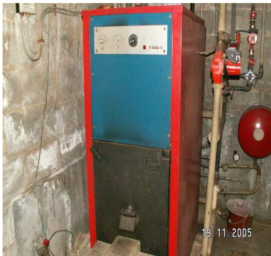
Figure 1.4: exemple de vieille chaudière
