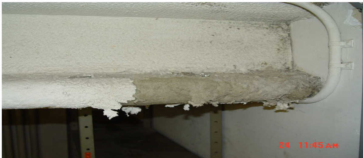
Figuur 4.3.3: Asbestspuitlagen (60 tot 80% asbest)
