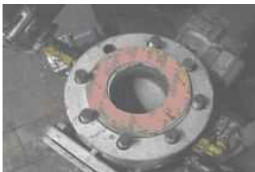
Figuur 4.3.6: Asbesthoudende afdichting type "klingerite" tussen de flenzen van verwarmingsleidingen
