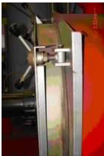
Figuur 4.3.7: Koord op de deur van een verwarmingsketel
