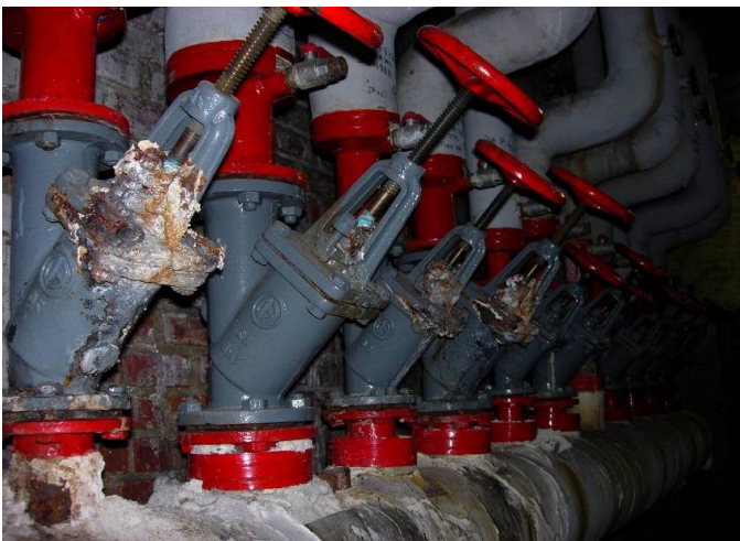
Afbeelding 3.9: isolatiekranen, voorzien van een klep met schuine zitting (moet thermisch geïsoleerd en hersteld worden)
