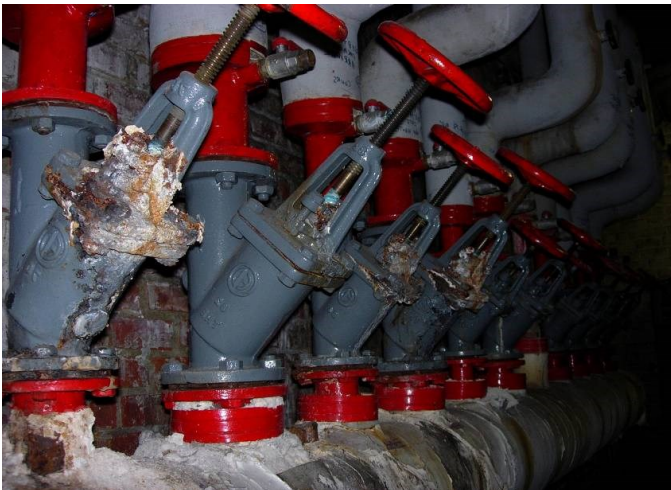
Afbeelding 3.9: isolatiekranen, voorzien van een klep met schuine zitting (moet thermisch geïsoleerd en hersteld worden)
