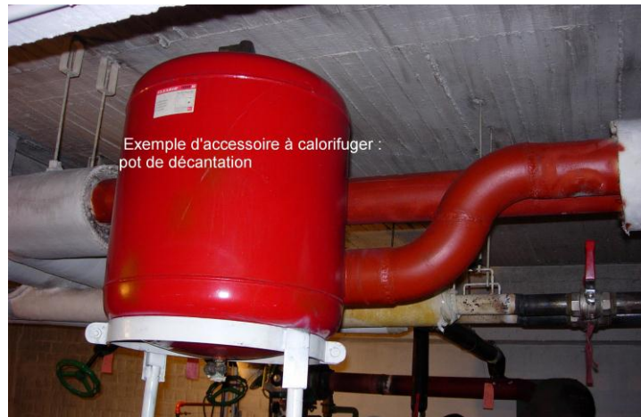
Figure 7 – Pot de décantation à calorifuger
