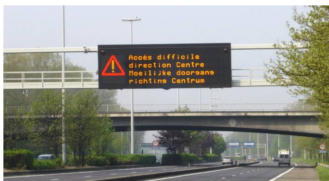
Panneaux à messages variables (arrivées d'autoroute, tunnels...)
