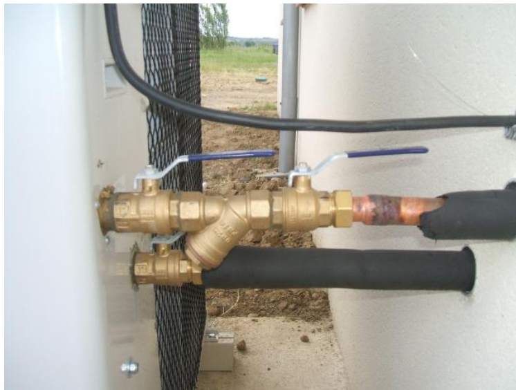
Figure 2.15 Exemple d'isolation à terminer sur les vannes d'une pompe à chaleur réversible
