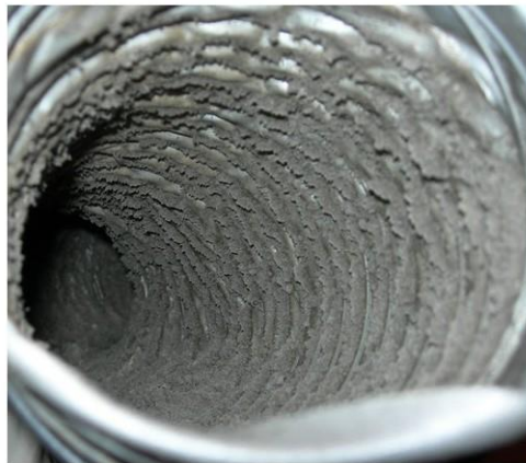
Figuur 2.13 : binnenwanden van een luchtkanaal vuil
