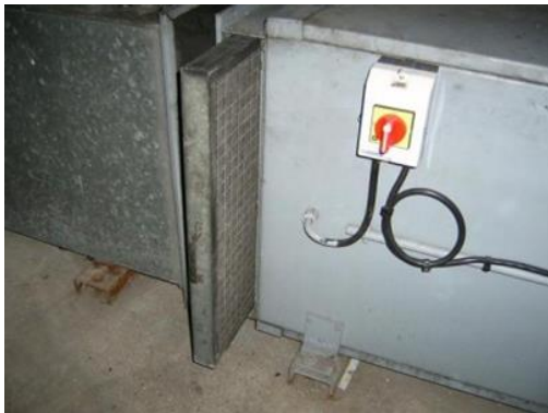
Figuur 2.4 filter visueel controleren
