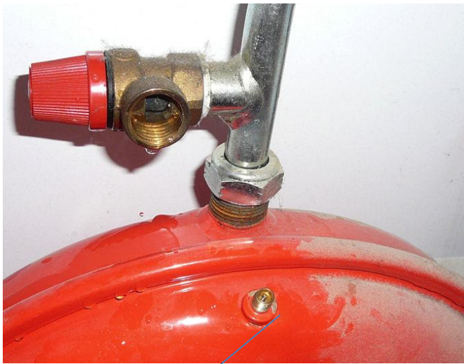
Figuur 2:22 Controle- en opzwelpunt van het expansievat (na isolatie en afzetten van de tegendruk van het water)
