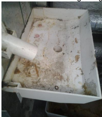
Figuur 2.21 condensaatopvangbak van een ventilo-convector voor het reinigen
