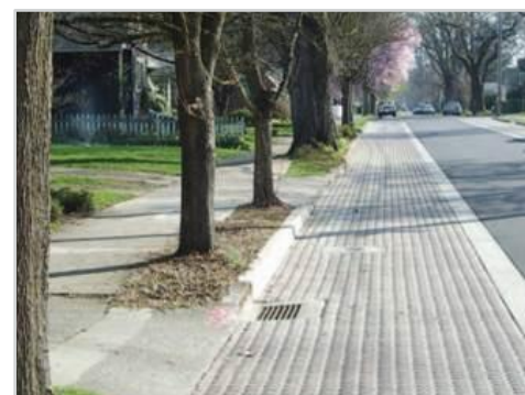
Mangaten en bestaand netwerk voor de afvoer van water bij buitengewone regenval (> 2-jarig)
