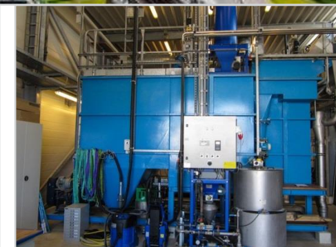
Het water van het kanaal wordt behandeld, vooraleer het in Ørestad terechtkomt. Zo wordt er 100.000 liter water per uur gezuiverd.
