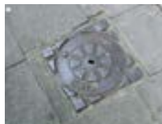
Plaque individuelle du réseau de distribution
