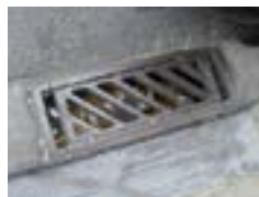
De rioolkolken die het afvloeiende regenwater opvangen
