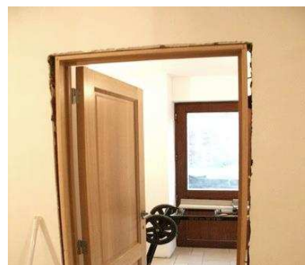
Figure 45 : Mauvaise liaison maçonnerie / chambranle
