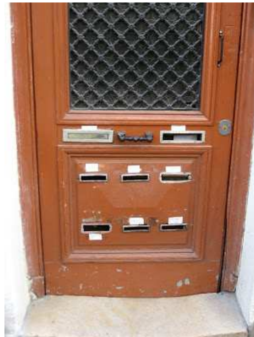
Figure 50 : Boîtes aux lettres multiples = fuites acoustiques multiples
