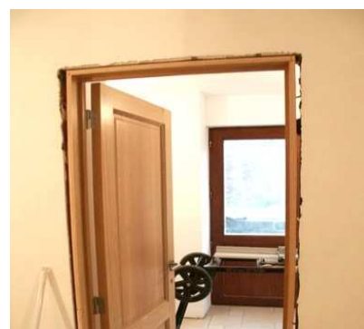
Figuur 45 : Slechte verbinding metselwerk / kozijn
