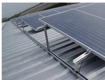
Figuur 4: Fotovoltaïsche zonnepanelen gemonteerd op een metalen draagstructuur die is verankerd op het dak, Limburgse Tuinbouwveiling, Herk-de-Stad (3E)
