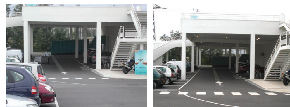
Surverses intégrées aux escaliers
