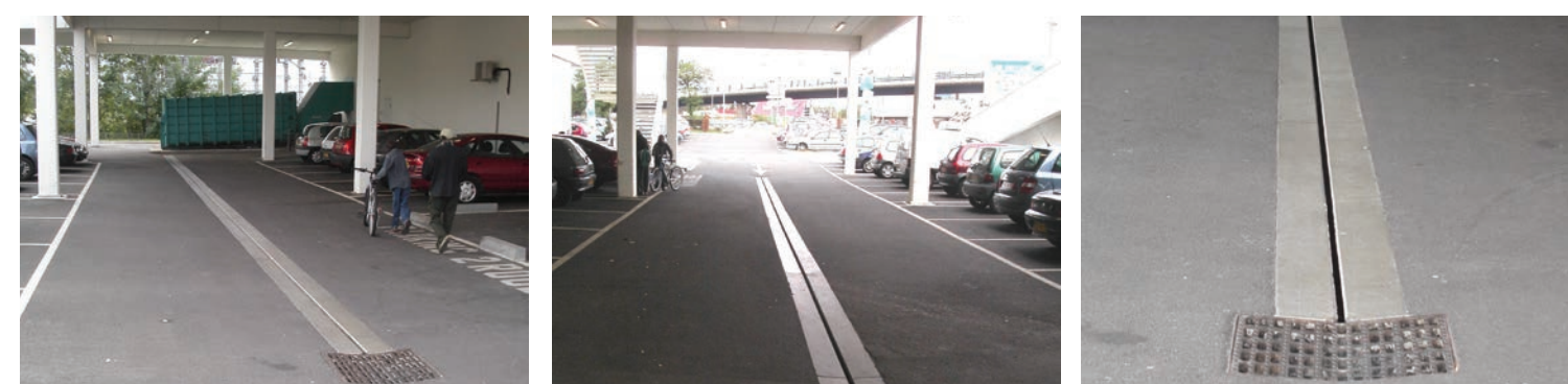
Dispositifs de collecte et transport des eaux pluviales à ciel ouvert
