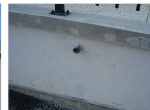
Dispositif d'évacuation des eaux pluviales
