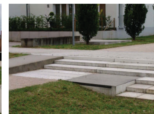
Surverses intégrées aux escaliers
