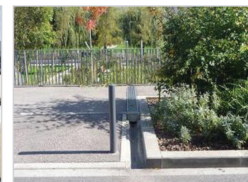
Réseaux de collecte des eaux pluviales
