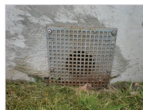
Connection entre le bassin et le filtre
