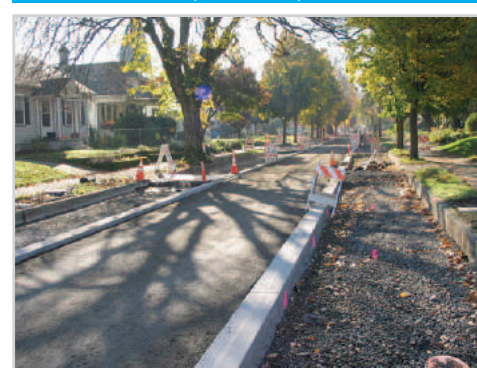
La «couche de drainage» se prolonge sous toute la largeur de la voirie
