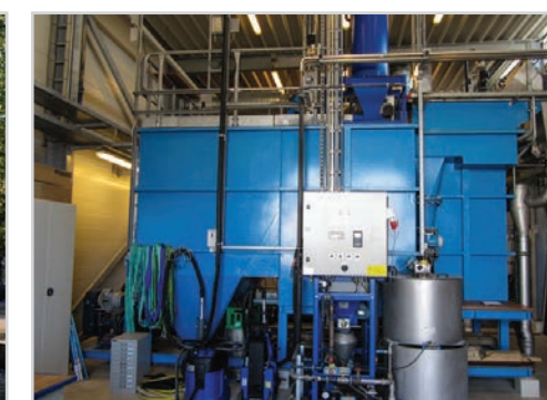
L'eau du canal est traitée avant d'être rejetée dans Ørestad. 100 000 litres d'eau sont traités par heure
