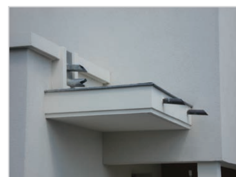
Dispositif d'évacuation des eaux pluviales
