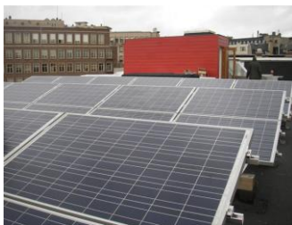
FV panelen op dak
