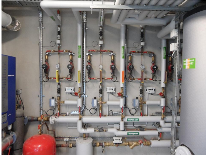
Een “eenvoudige” stookplaats van een gebouw
