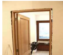
Figure 45 : Mauvaise liaison maçonnerie / chambranle
