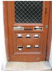
Figure 50 : Boîtes aux lettres multiples = fuites acoustiques multiples
