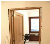
Figure 45 : Mauvaise liaison maçonnerie / chambranle
