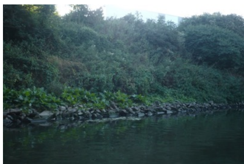
Enrochement (Rive droite – S12)
