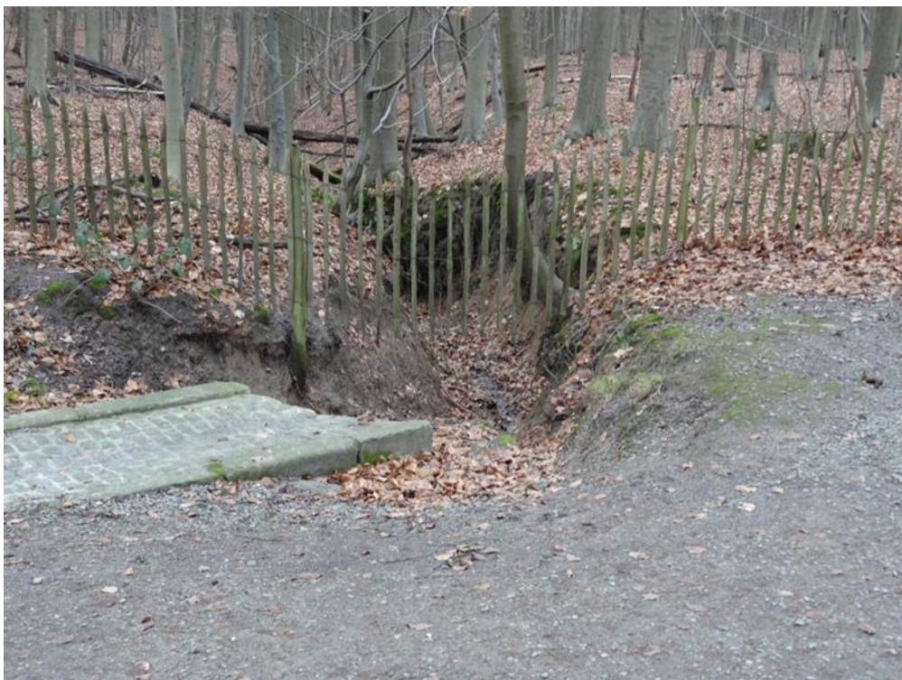
Foto 6.1 – Aanvoer van het afvloeiend water van de gemeenteweg
