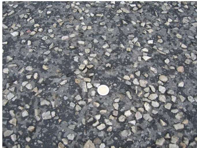
Figuur 6 – begrind asfaltbeton.
