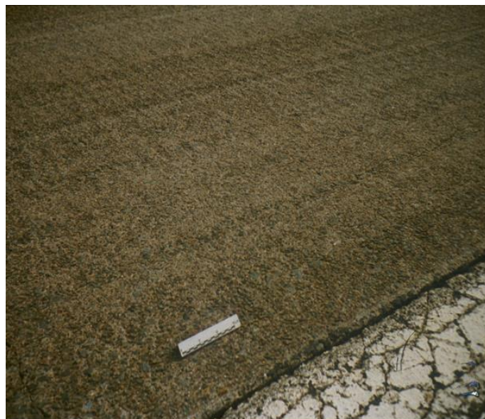
Figuur 34 - ongewenste golvingen in een betonoppervlak in het megatextuurgebied ten gevolge van het gebruik van een transversale balk bij de aanleg.
