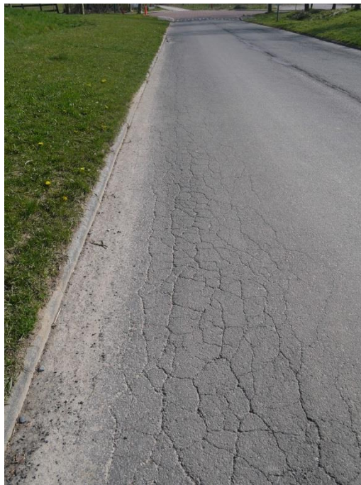
Figuur 36 - megatextuur ten gevolge van vermoeiingsscheuren in asfalt.
