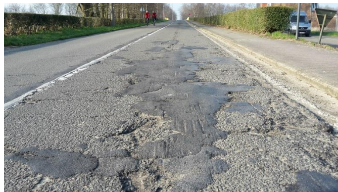
Figuur 77 - slordig, met gietasfalt hersteld asfaltwegdek.
