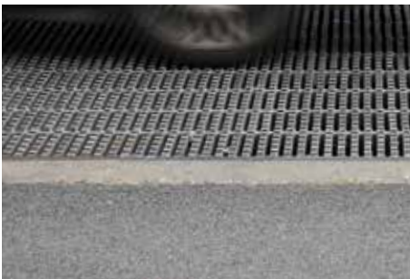
Grille de ventilation d'un tunnel
