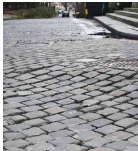
Voirie dégradée en pavés
